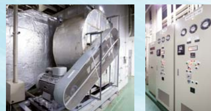
空調機用送風機のモータを高効率モータとインバータ盤との組み合わせ制御に更新
