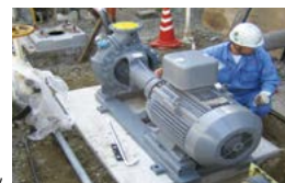
ポンプのリニューアル
