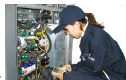
圧縮機の負荷率測定
