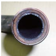
吐出し配管内側に堆積した炭化物の一例です。
