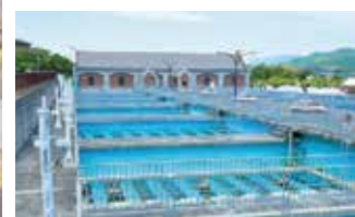
浄水場 エアレーション
