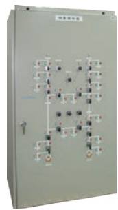
特高操作盤、所内電源盤
