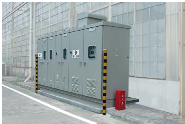
更新後設備例
