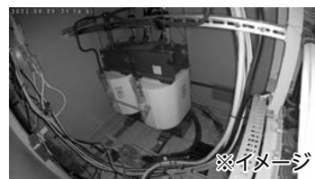
変圧器盤内撮影例(夜間扉閉状態)
