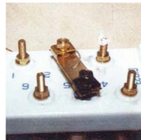
タップ切換片締付部の溶損(油入ガス分析にて発見)
