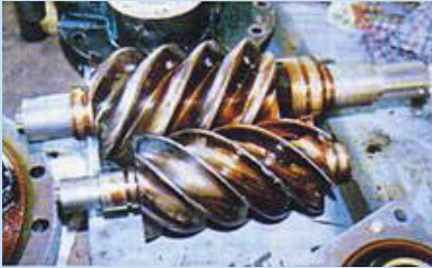
潤滑油劣化によりロックした圧縮機 (スクローロータ部)
