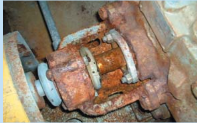
経年劣化により腐食、水漏れしたポンプ (グランド部)
