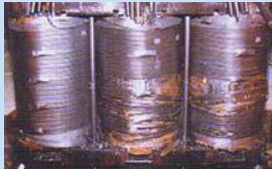
絶縁紙劣化によりコイルが破損した変圧器
