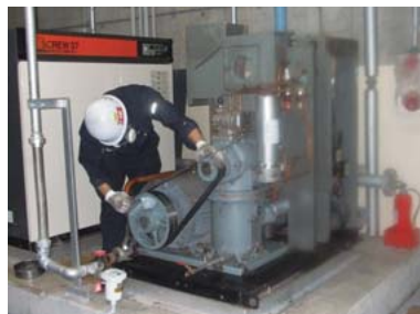
圧縮機：点検・整備
