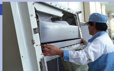
HEPAフィルタ交換
